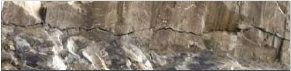
Рис. 1. Фотография траектории трещины
